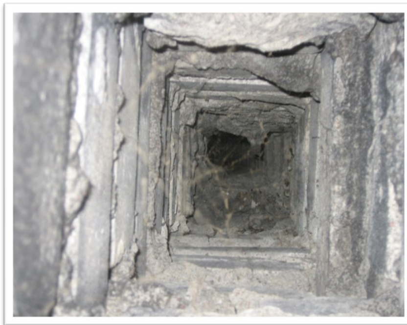
Puhastamata ventilatsioonikanali tõttu
